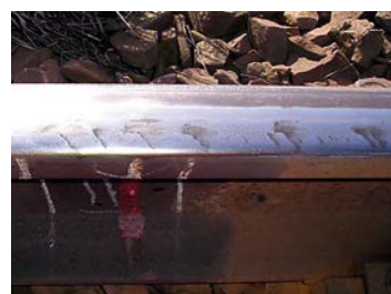
Rys. 2. Wada head check w stanie zaawansowanym [źródło własne] Fig. 2. Head check defect at the advanced stage [own source]
