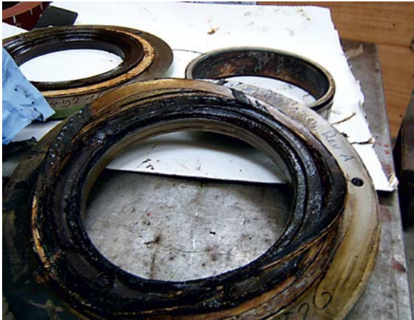
Rys. 10. Uszkodzone łożysko generatora Fig. 10. Generator bearing defective
