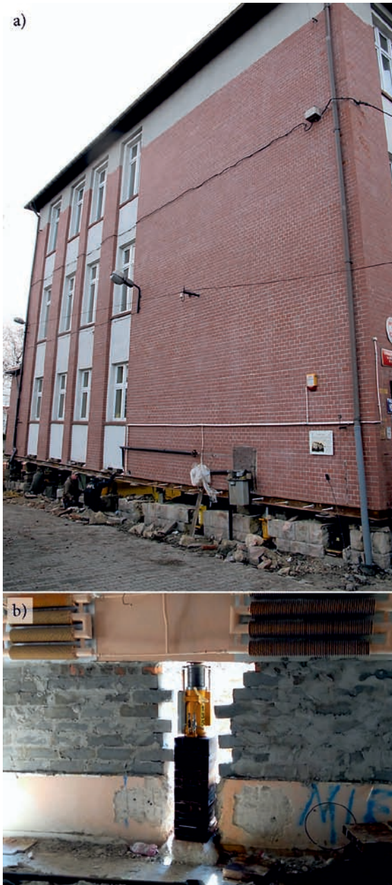
Rys. 2. Tymczasowe podpory budynku: a) układ podpór zabudowany w ścianie budynku, b) pojedyncza podpora złożona z siłownika i stosu stalowych elementów prostokątnych Fig. 2. Temporary supports of the building: a) system of the supports built in the wall of the building, b) single support consisting of jack and stack of cuboid steel elements
