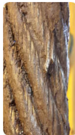
Rys. 3.4. Pęknięte druty. Fig. 3.4. Broken wires
