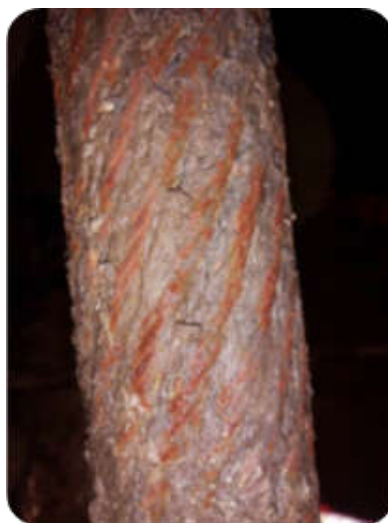
Rys. 3.3. Korozja zewnętrzna. Fig. 3.3. External corrosion
