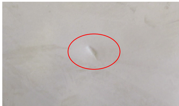
Rys. 7a. Uszkodzenie eksploatacyjne poszycia SP [8].
