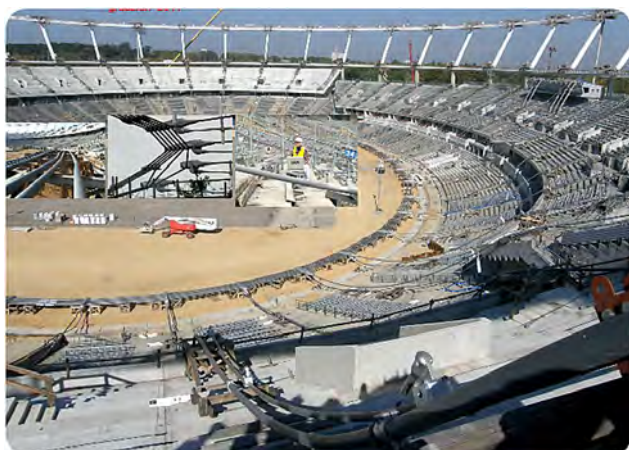
Rys. 12. Badanie stanu lin Stadionu Śląskiego po awarii w czasie podnoszenia dachu
